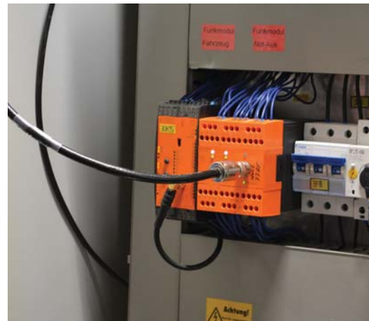
Die Sicherheits-Funkmodule von Dold sind im Schaltschrank in der unteren Etage bei der Strangpressanlage untergebracht.
